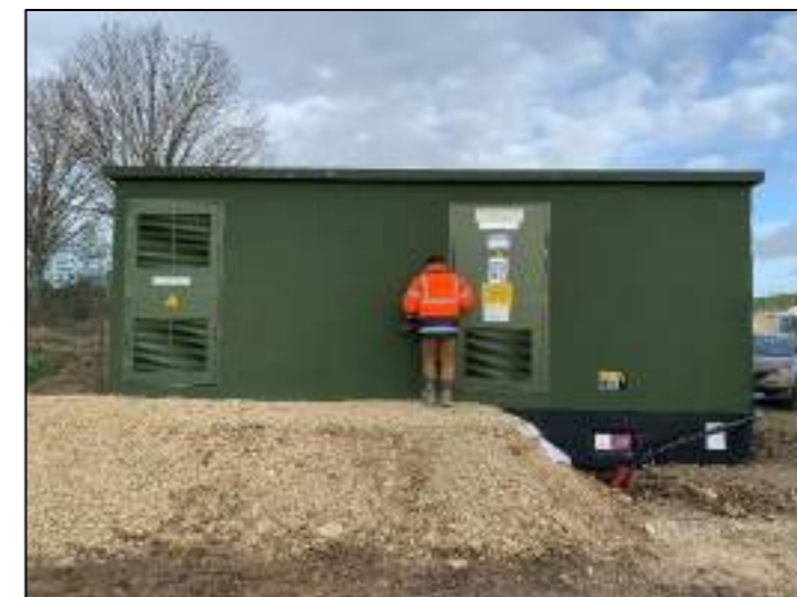
Exemple de poste de livraison
