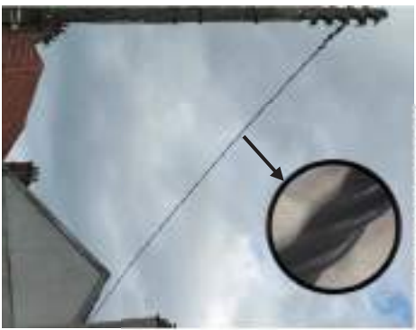
Réseau fils isolés aérien BT
