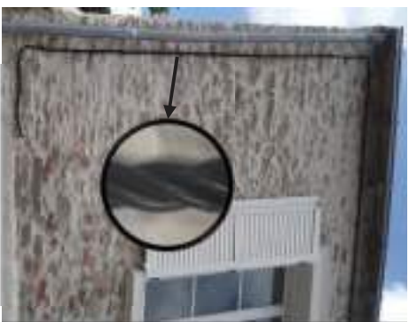
Réseau fils isolés façade BT
