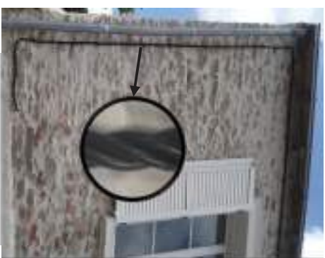
Réseau fils isolés façade BT
